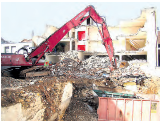
Ein Stück altes Gundeli ist verschwunden. Baustellen-Zwischenfoto aus der Bruderholzstrasse 20 von Martin Graf.
