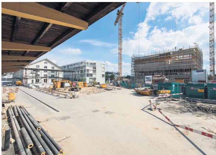
Am Freilager-Platz im Dreispitzareal entsteht der Neubau für die Hochschule für Gestaltung und Kunst FHNW.
