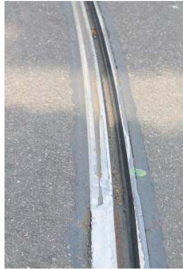
Die abgenutzten Schienen auf dem Tellplatz müssen dringend ersetzt werden. Foto: GZ
