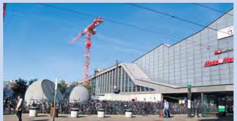
Die SBB-Passerelle, mit ihrer architektonischen Berglandschaft, wurde damals nicht zukunftsorientiert gebaut.
