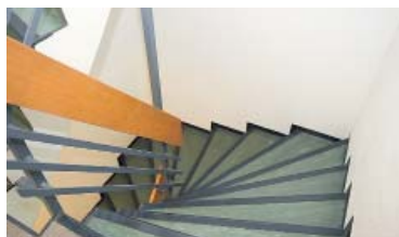
Dieses Treppenhaus ist laut Brandschutzvorschriften zu schmal.
