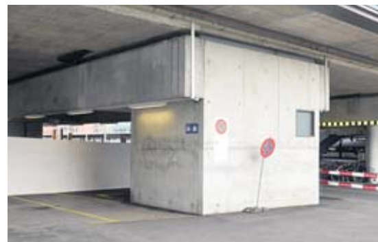
Ebenfalls unter der Passerelle bei der Meret Oppenheim-Strasse riecht es stark und die Urinrückstände sind gut sichtbar.
