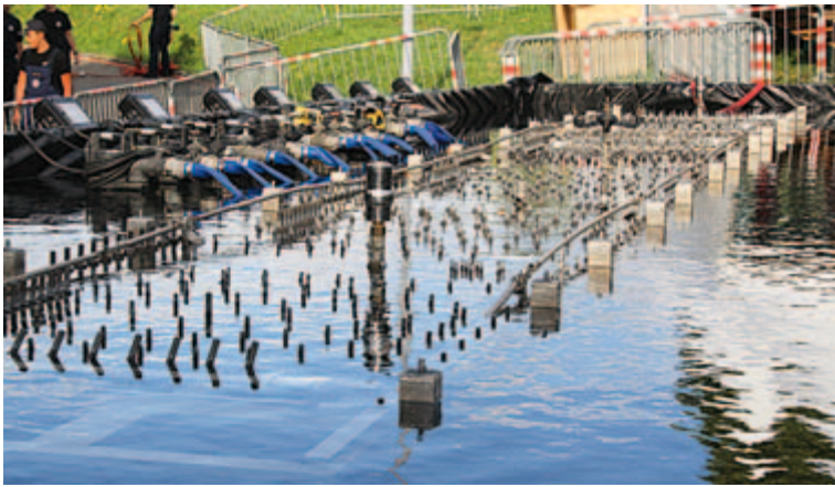
Imposante Technik: Wasserbecken mit Pumpen und Düsen. Fotos: Thomas P. Weber
