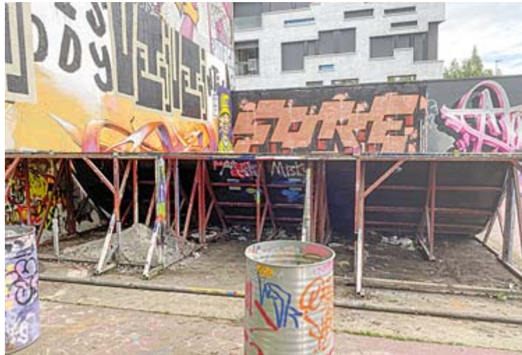
Sichtbares Gerüst der Skateanlage im Purple Park, nach teilweiseem Abbruch.
